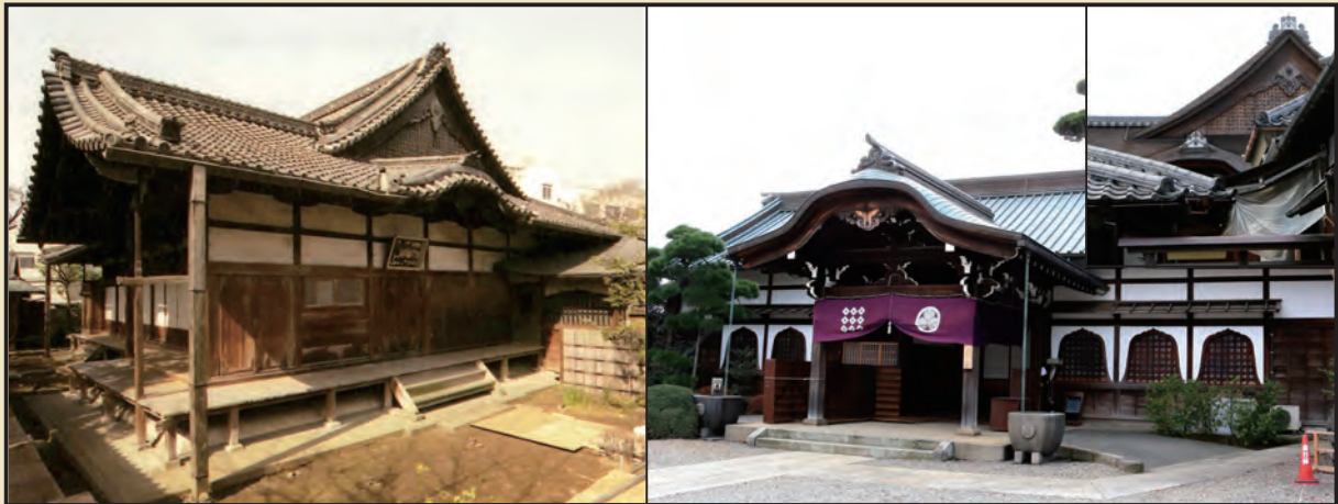
写真1：改修前の護国寺「月光殿」（左）。創建時は檜皮葺の建物であったが、明治時代に移築された際、瓦葺に改められた。現在の「月光殿」前屋（右）。現在月光殿は通常公開はされていないが、側の多宝塔の近くから改めて檜皮葺に直された屋根が見える（右上）。（左写真：東京都教育委員会提供）
