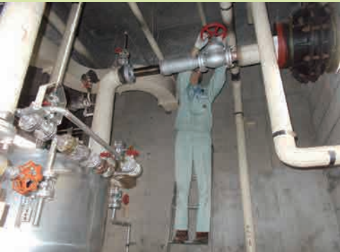
地域冷暖房システムからのバルブ開閉
