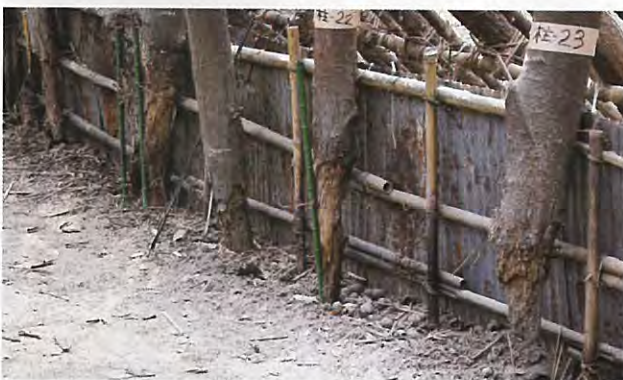
根元が痩せてしまった柱（解体時に撮影）
