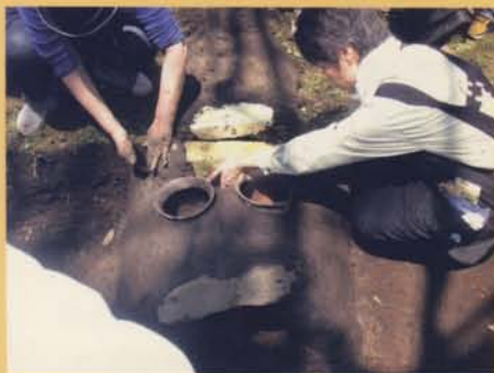
4. 真ん中に2個の甕をはめ込んで、しっかりと天井部を積み上げる。ここが一番難しい。
